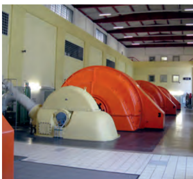
Blick in die Maschinenhalle im Kraftwerk Uttendorf I. Die Verantwortlichen gehen davon aus, dass die Wasserkraftgeneratoren, die seit 1950 im Einsatz sind und unlängst komplett überholt wurden, nun weitere 25 Jahre problemlos funktionieren.
