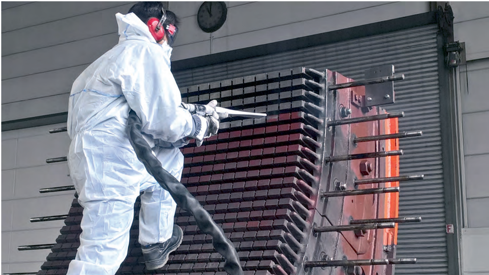
Ein enger Zeitplan: Die überholten Generatoren mussten pünktlich zur Schneeschmelze wieder im Kraftwerk laufen, damit sie bereits ab dem Frühjahr wieder Strom produzieren konnten. Bilder: Baumüller
