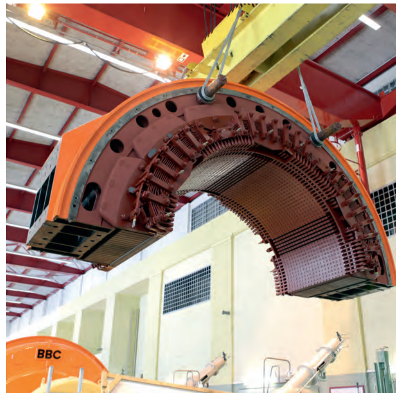
Die überholte Statorhälfte wurde wieder im Wasserkraftwerk Uttendorf I eingesetzt.
